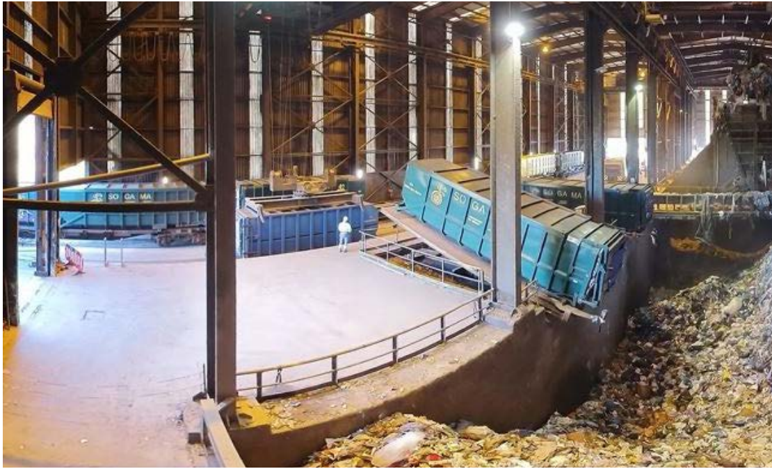
Planta de Tratamento e Elaboración de Combustible do Complexo Medioambiental de Sogama.
